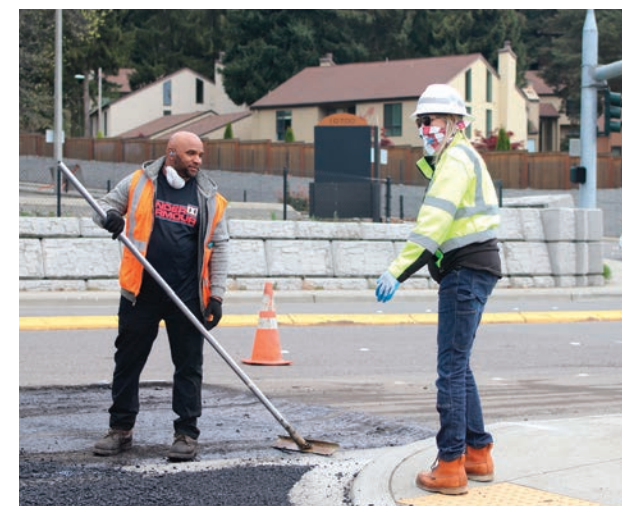
Cheryl Dowse, right-of-way inspector, делает средства индивидуальной защиты из подручных средств, так как она следит за строительством улиц.
